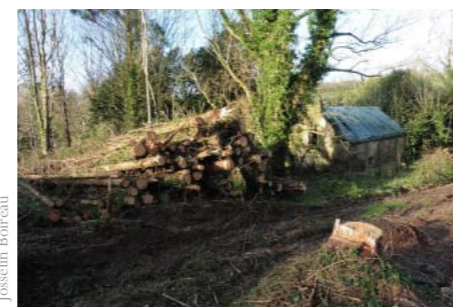
Bâtiment récemment acquis (29) suite à des chantiers de mise hors d'eau et de coupe de résineux.
