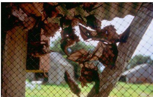
Colonie de Grands rhinolophes piégée par la mise en place de grillage anti-pigeons sur un clocher. N. NICOLAS
