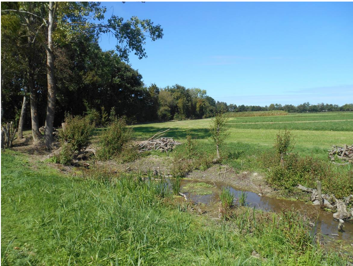
Premiers travaux de réouverture d'un cours d'eau sur l'ENS de Piré Chancé (35) en septembre 2020 © Thomas Le Campion
