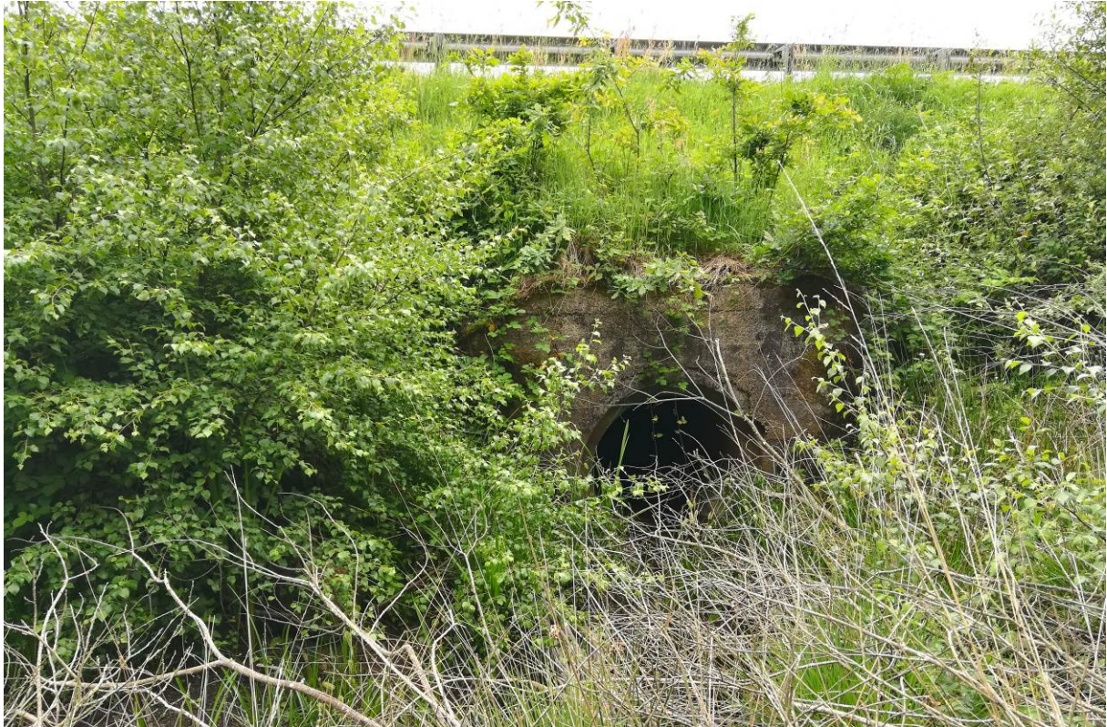
Buse hydraulique empruntée pour traverser la RN12
