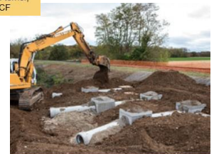
Mise en place de la butte en terre au-dessus du terrier - Photo SNCF
