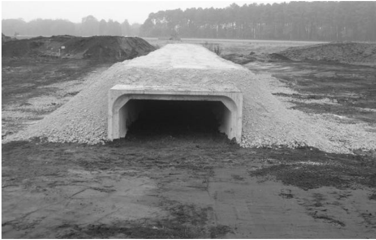
Figure 11: Buse sèche rectangulaire franchissant une zone humide assurant également la circulation des amphibiens
