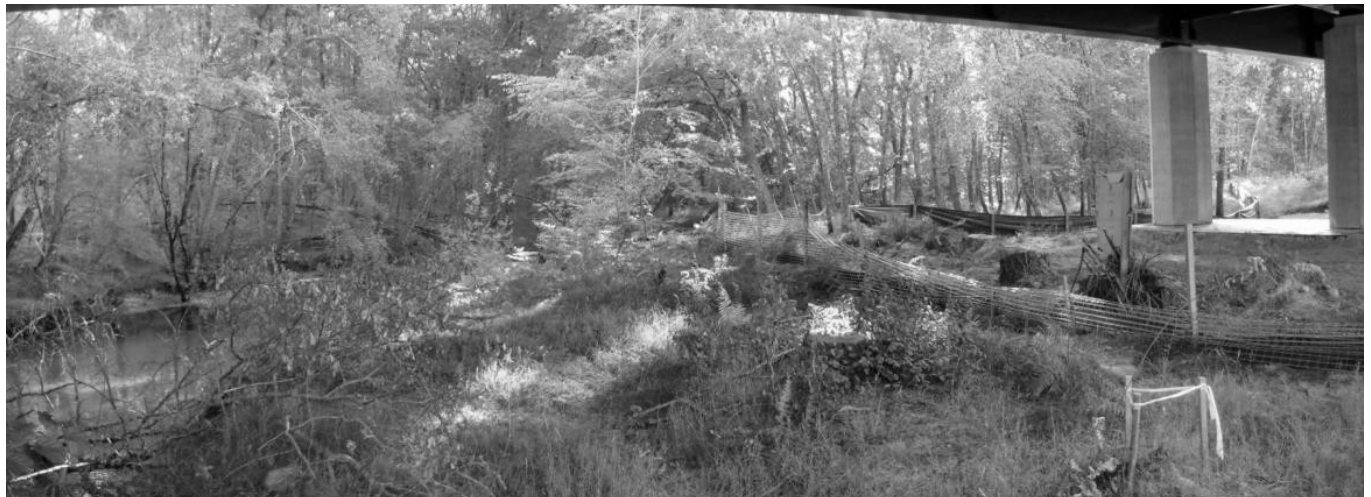
Figure 6: Construction d'un viaduc enjambant un lit majeur large : la zone chantier autour des piles est délimitée concrètement par une protection physique amovible (filet), afin d'éviter tout débordement des engins et personnels risquant la destruction des habitats d'origine sous l'ouvrage.
