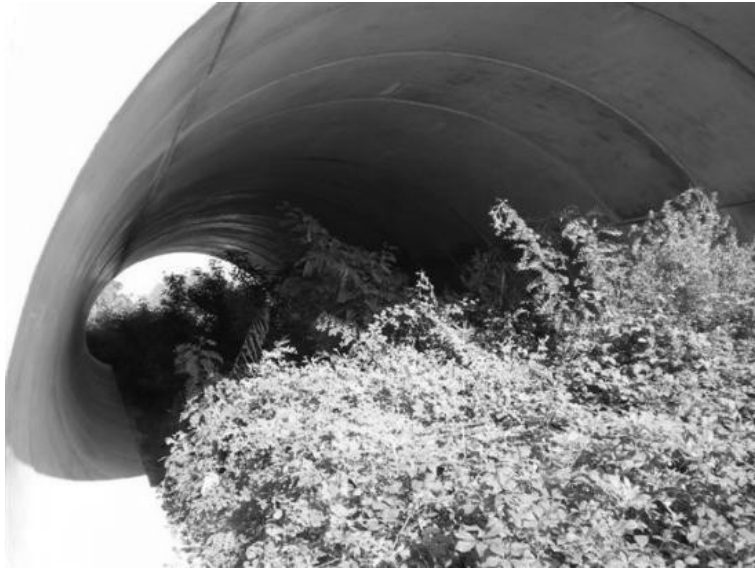
Figure 9: Autre type d'ouvrage préservant le lit mineur (0,50 mètre de large) et les berges, construction achevée.
