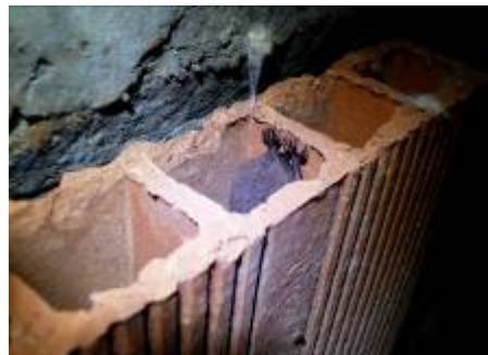
Très simple à réaliser chez soi, ou à conseiller quand on fait la visite chez un particulier pour la création d'un Refuge chauves-souris : la pose de briques plâtrières, en intérieur dans une cave ou même sur un mur extérieur.
